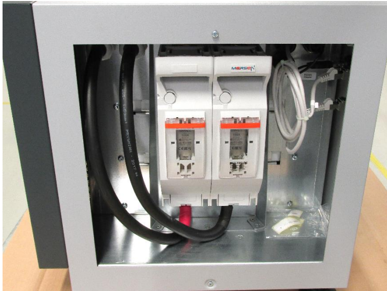
Abbildung 4-7 Batteriespeichersystem, Seitenansicht geöffnetes Gehäuse
